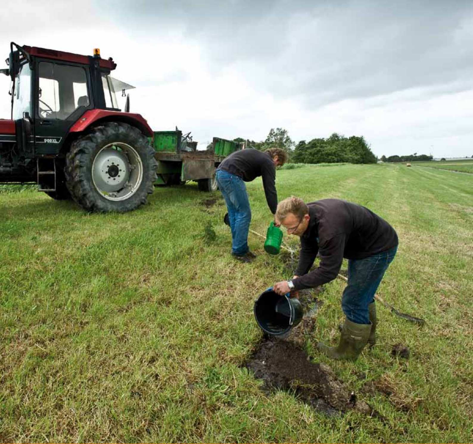
Medewerkers van een aannemer repareren met aarde en water scheuren in de veendijk langs de Zweth bij Den Hoorn. De scheuren zijn ontstaan door langdurige droogte.
