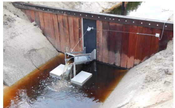
Figuur 1: De geplaatste 'slimme stuw' op het bedrijf van Bakhuis in Arriën (foto: P.B. Worm).
