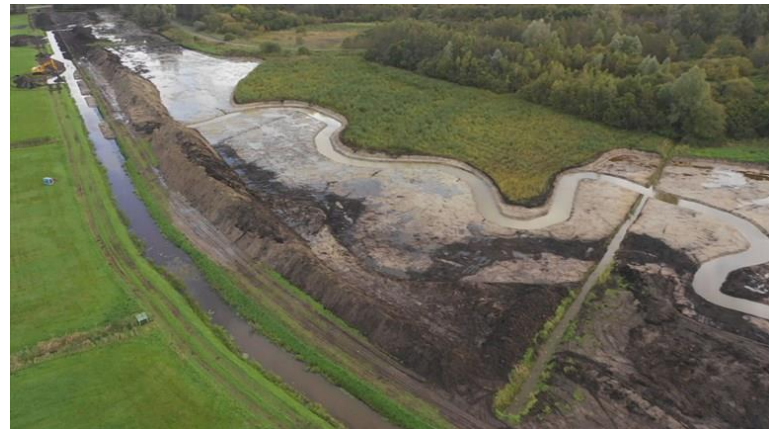
Foto: herstel Witterdiep. Bron: RTV Drenthe
