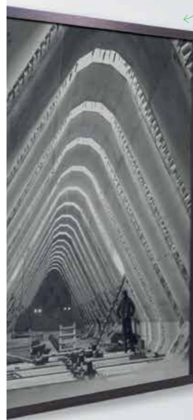
De bouw van de spuisluizen van de Haringvlietdam in 1963. Foto: Beeldbank Rijkswaterstaat. Ton van der Sluis
