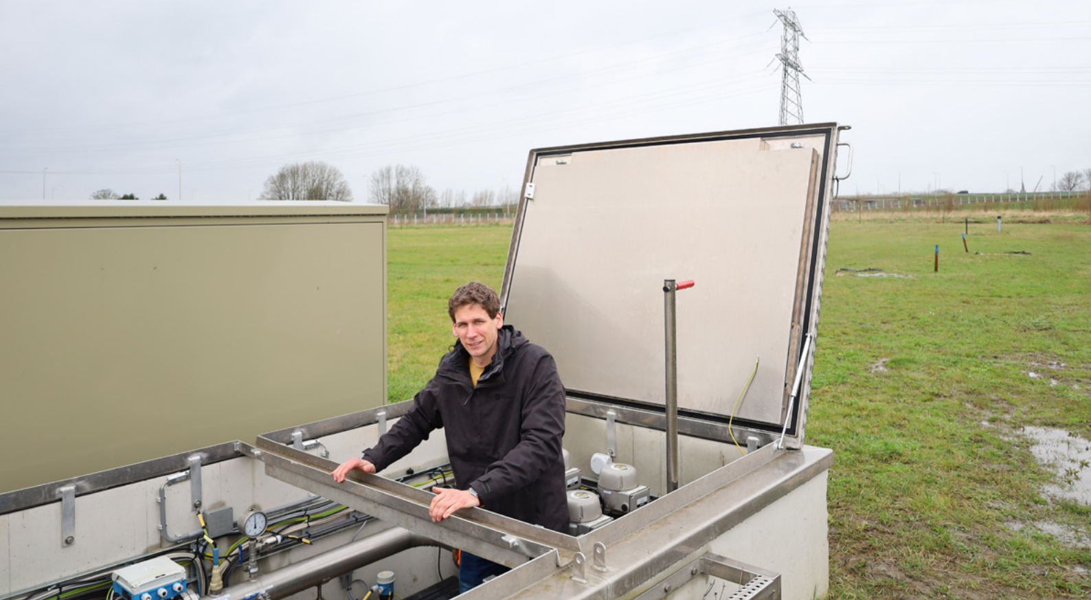
Figuur 13 Strategisch adviseur Koen Zuurbier bij de waterput van de ondergrondse drinkwateropslag in Hoorn
