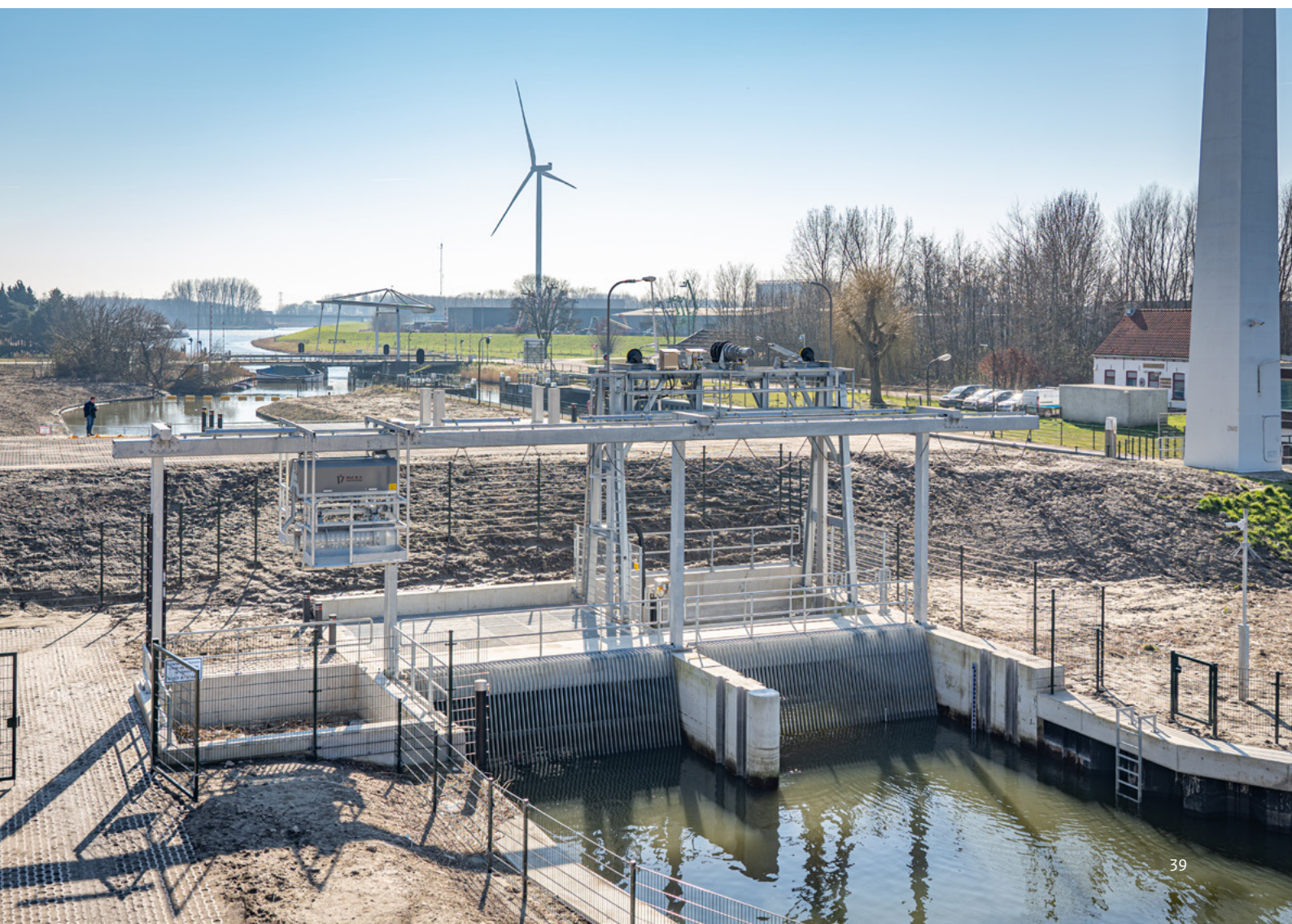
Figuur 19 De inlaatvoorziening bij sluis Roode Vaart in Moerdijk
